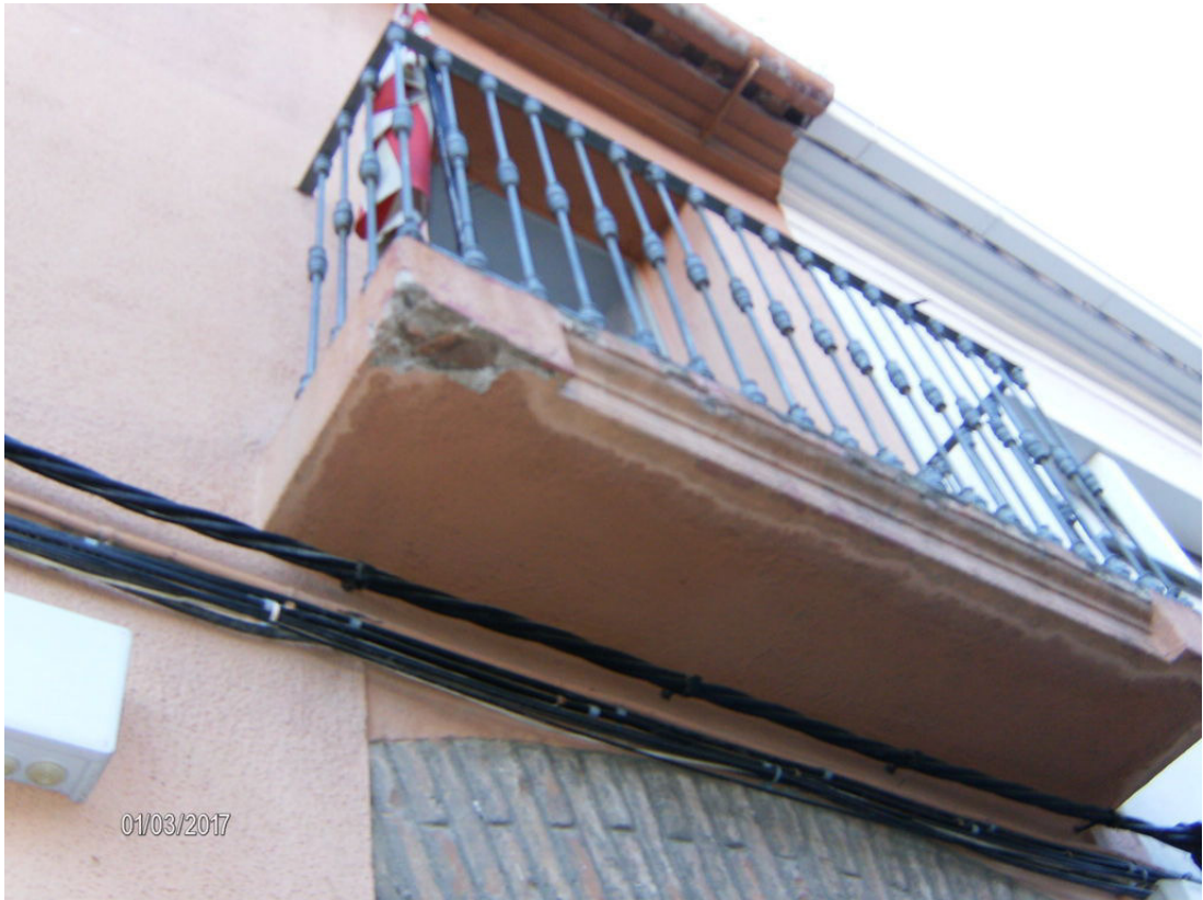
Balcó trencat a la cantonada
