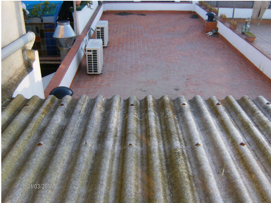
Plaques ondulades a substituir per policarbonat
