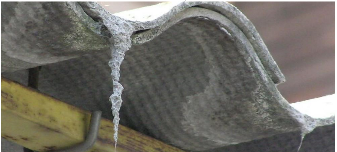
EJEMPLO DE UNA PLACA ONDULADA (CONOCIDA COMUNMENTE CON EL NOMBRE DE URALITA) QUE HA PERDIDO SUS PROPIEDADES CONVIRTIÉNDOSE EN FRIABLE, DESPRENDIENDO FIBRAS DE AMIANTO AL AMBIENTE
