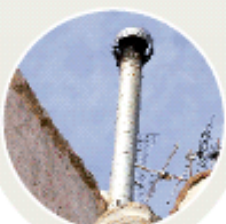
CHIMENEAS Y CONDUCTOS DE AIRE En tejados y salidas de humos
