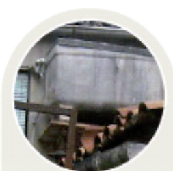
DEPÓSITOS DE AGUA Rectangulares y cilíndricos en terrados e interiores
