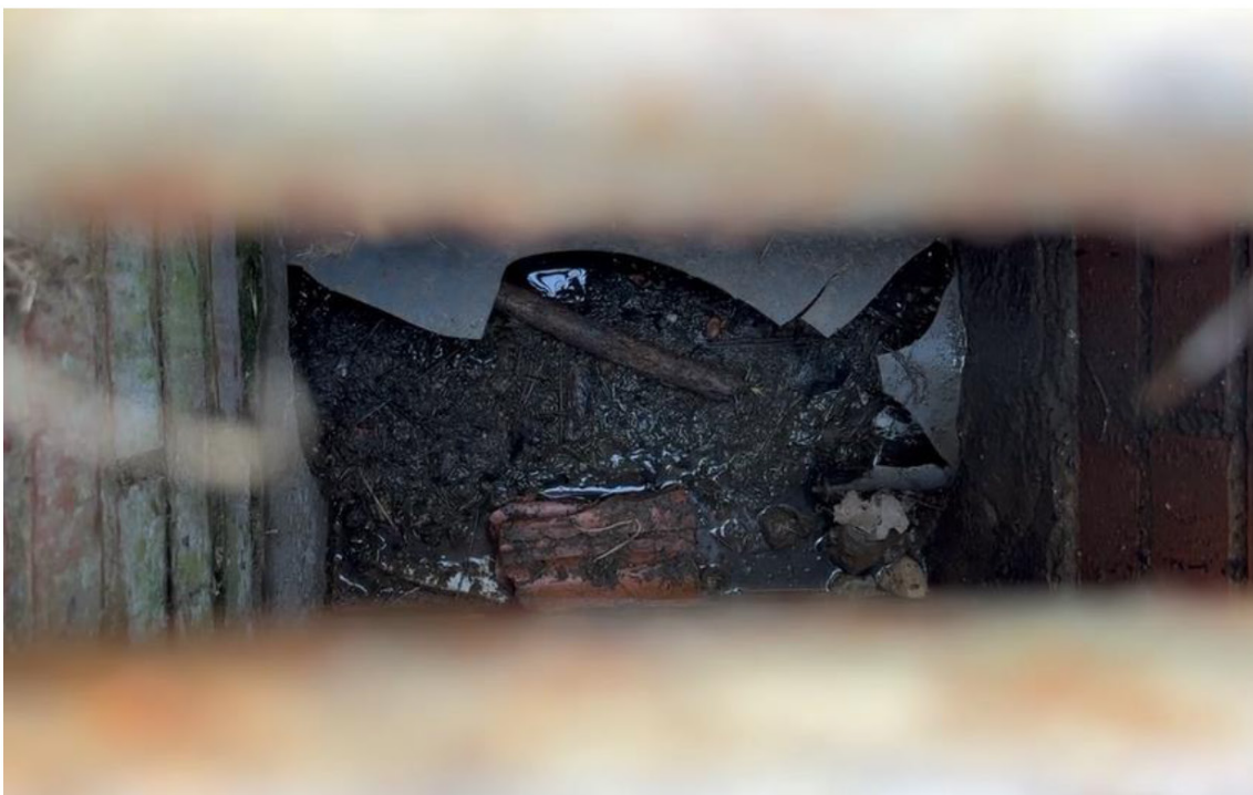
Figura 4 – Conducció PVC arqueta trencat
