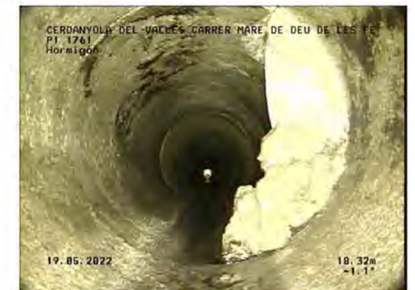
P1 A 1761_5d1544b2-802d-47ed-8fdb-dffdc759e487_20220519_095502_527.jpg, 00:02:02, 18.32 Unión, conexión abierta,, altura: 81mm, anchura: 81mm a 3 Reloj / HORMIGÓN
