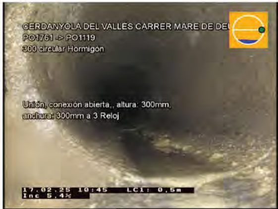
17_02_2025 10_43_56_eb3f38c4-4d73-4ac3-bda7-38a579cae199_20250217_104533_865.jpg, 00:00:12, 0.50m Unión, conexión abierta,, altura: 300mm, anchura: 300mm a 3 Reloj
