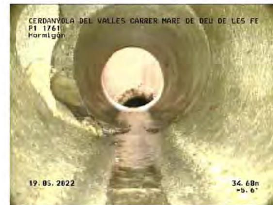
P1 A 1761_04cdf3ba-752f-4043-8357-2eefc6fff77f_20220519_095806_309.jpg, 00:04:47, 34.67 Unión, conexión abierta,, altura: 81mm, anchura: 81mm a 9 Reloj
