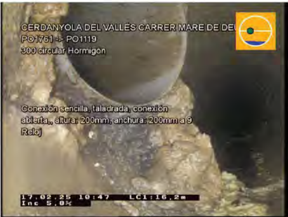
17_02_2025 10_43_56_93c1c0a4-6040-4549-b54e-9e4ee6a8539c_20250217_104712_085.jpg, 00:01:37, 16.20m Conexión sencilla, taladrada, conexión abierta,, altura: 200mm, anchura: 200mm a 9 Reloj
