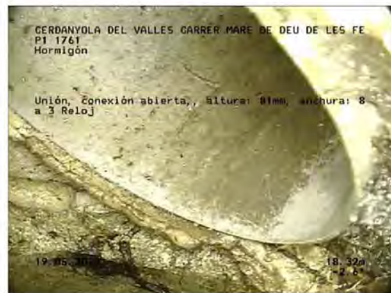
P1 A 1761_ed6ddf71-0c2e-4739-9ff8-61995e7a5d63_20220519_095453_102.jpg, 00:02:02, 18.32 Unión, conexión abierta,, altura: 81mm, anchura: 81mm a 3 Reloj / HORMIGÓN
