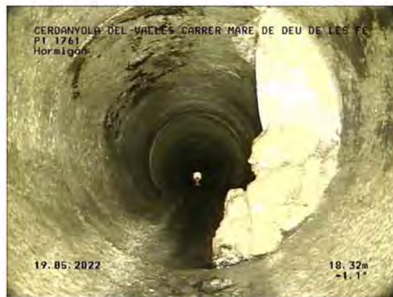
P1 A 1761_5d1544b2-802d-47ed-8fdb-dffdc759e487_20220519_095502_527.jpg, 00:02:02, 18.32 Unión, conexión abierta,, altura: 81mm, anchura: 81mm a 3 Reloj / HORMIGÓN
