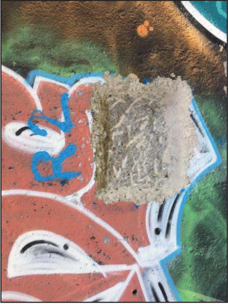
Imatge 2: Roza de dimensions de 30x30x10 cms efectuada a 1,5 metres de la superfície topogràfica actual, a la cara exterior del mur. No s'observa armadura.
