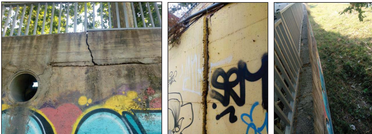
Imatges de les patologies observades al mur. D'esquerra a dreta: esquerda de tracció, moviments diferencials dels diversos trams de mur i bolcada.
