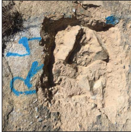
Imatge 2: Roza de dimensions de 30x30x10 cms efectuada a 1,5 metres de la superfície topogràfica actual, a la cara exterior del mur. No s'observa armadura.
