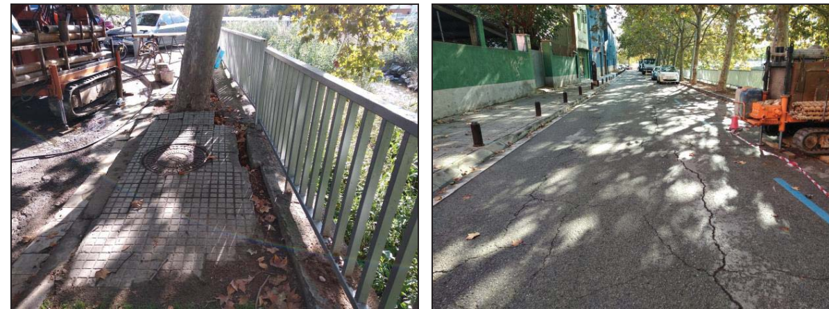
Imatges de les patologies observades al carrer Passeig del Pont.
