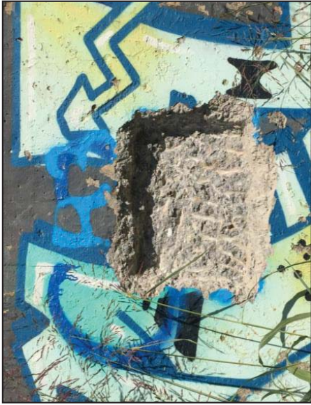
Imatge 2: Roza de dimensions de 30x30x10 cms efectuada a 1,5 metres de la superfície topogràfica actual, a la cara exterior del mur. No s'observa armadura.
